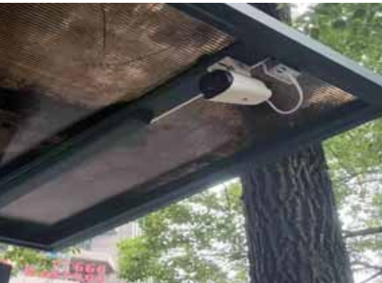
位于公交站亭顶棚下的枪型摄像头。
