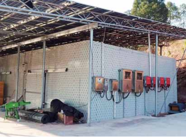
泉怡合作社冷藏库上方安装了光伏发电板。
