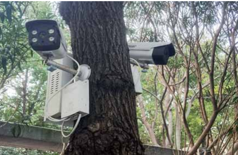
监控器布设在大树上,铁钉扎进树中。
